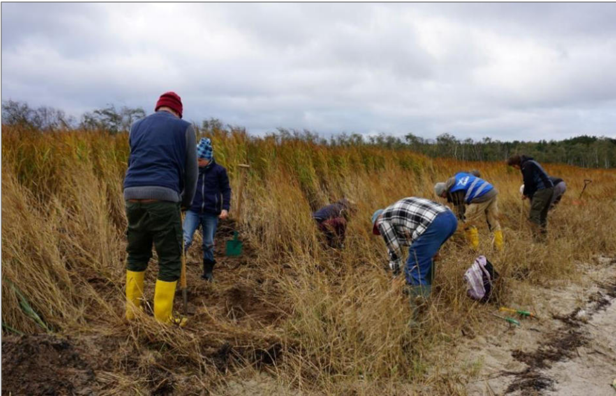
Abb. 3: Bevor die Reifen mit dem Kran aus dem Sand gehoben werden können, müssen sie in mühsamer Handarbeit durch die Helfer*innen freigelegt werden. (Foto: C. Lühr)
